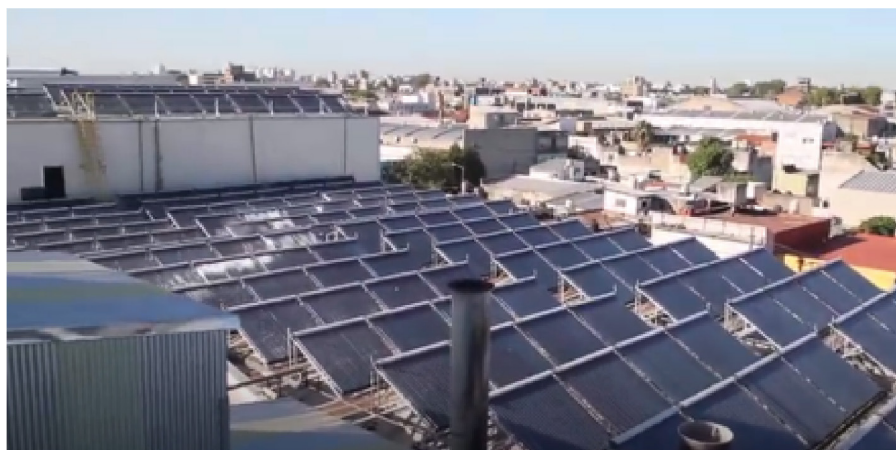
Fig. 12. Vista parcial del sistema de colectores solares en la cubierta de la tintorería industrial de tejidos Tikvatex SA, ubicada en San Martín, Buenos Aires
