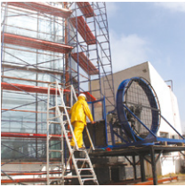
Cámara de ensayos de muros cortinas
