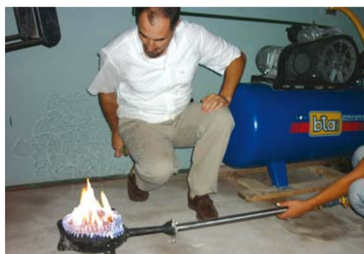
ENERGÍA. Puesta en funcionamiento del biodigestor, que tiene una capacidad de producir hasta 16 m 3 de biogás por día.
