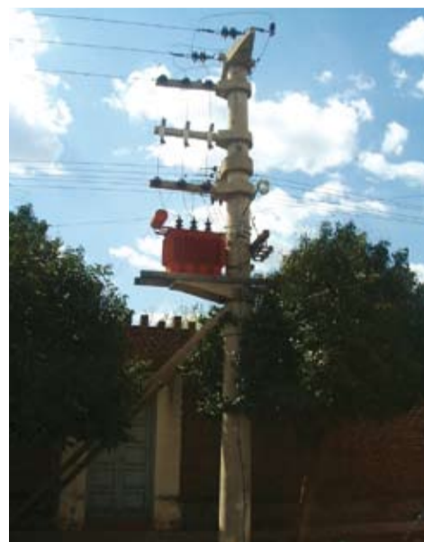
Servicio eléctrico: el informe del INTI le permitió a la comuna solicitar un subsidio al Ministerio de Planificación de la Nación para implementar mejoras.
