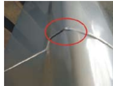
Presencia de una arista peligrosa. (Foto 2)
